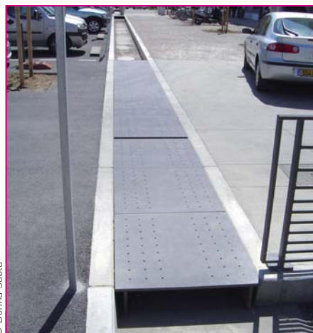
Pour récupérer les eaux de pluie, il a été installé de grands caniveaux ouverts, également en béton préfabriqué.
