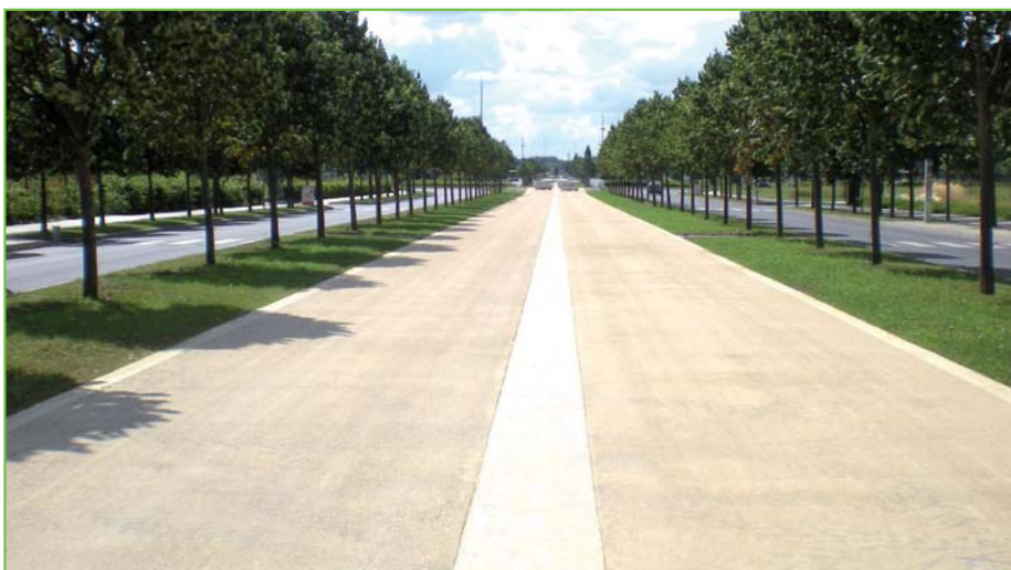
La voie du TZen hydrodécapée avec ses bordures et son caniveau central non traités.
